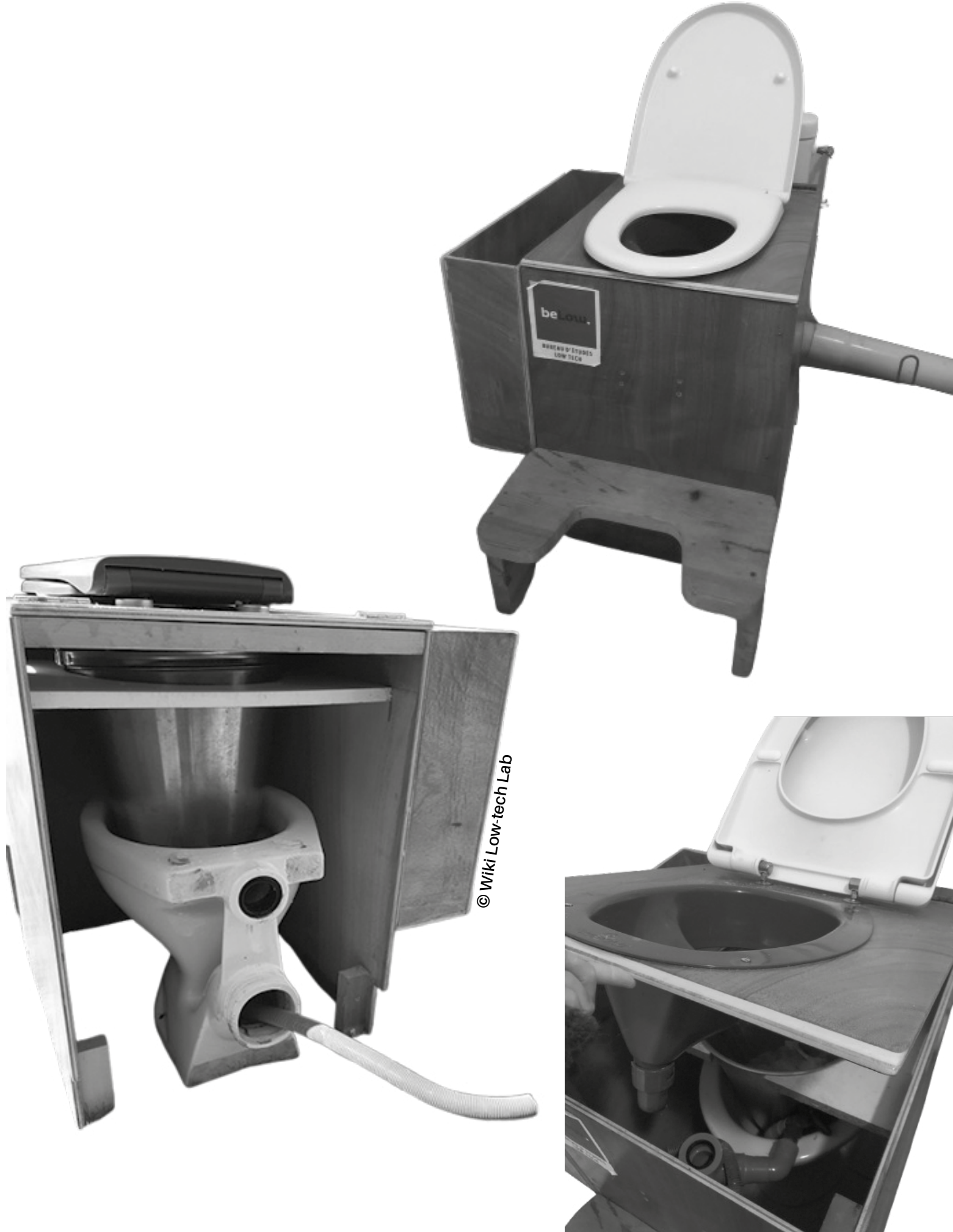
Toilettes sèches amovibles installées sur un toilette à eau existante, différentes vues.
